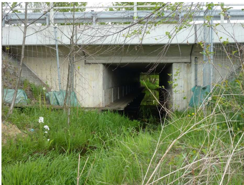
Abbildung 73: Eine mit einem „Ottersteg“ aus Holz nachgerüstete Brücke der Autobahn A 15 an einem Graben im Landkreis Spree-Neiße.- Foto: R. Möckel (10.05.2010)
